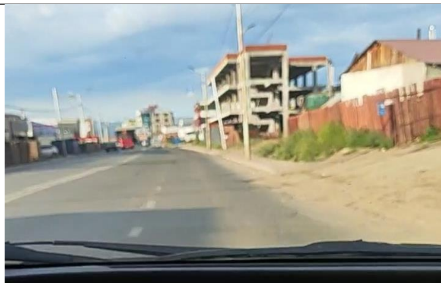
Тус замын орц гарц дээр ус ихээр тогтож хучилт нь эвдэрсэн байна.
