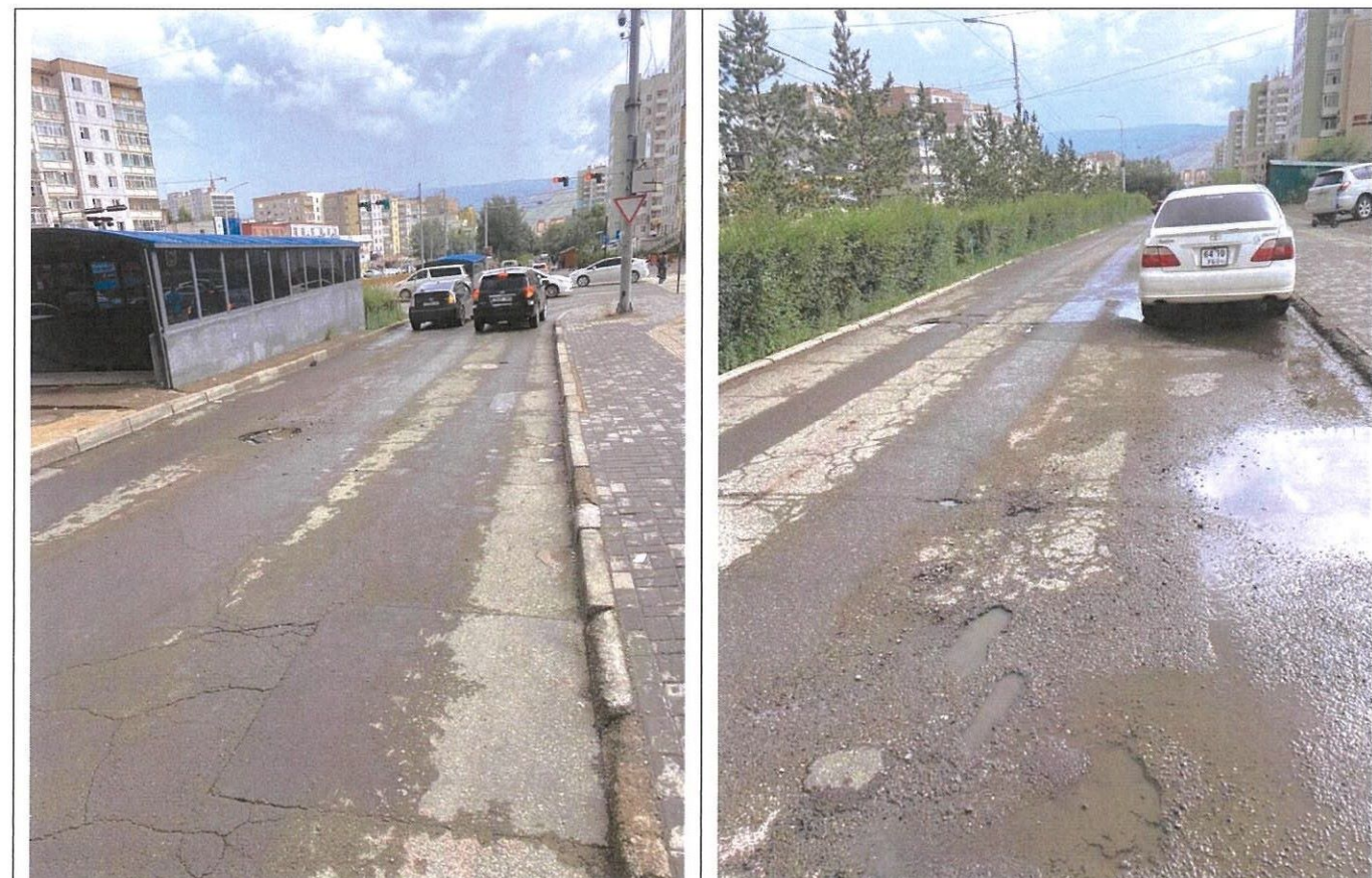
Замын дагууд нүхтэй хагарал ихтэй тул хөрөөдөн авч суурийн хамт зайлуулан нөхөөс хийнэ.
