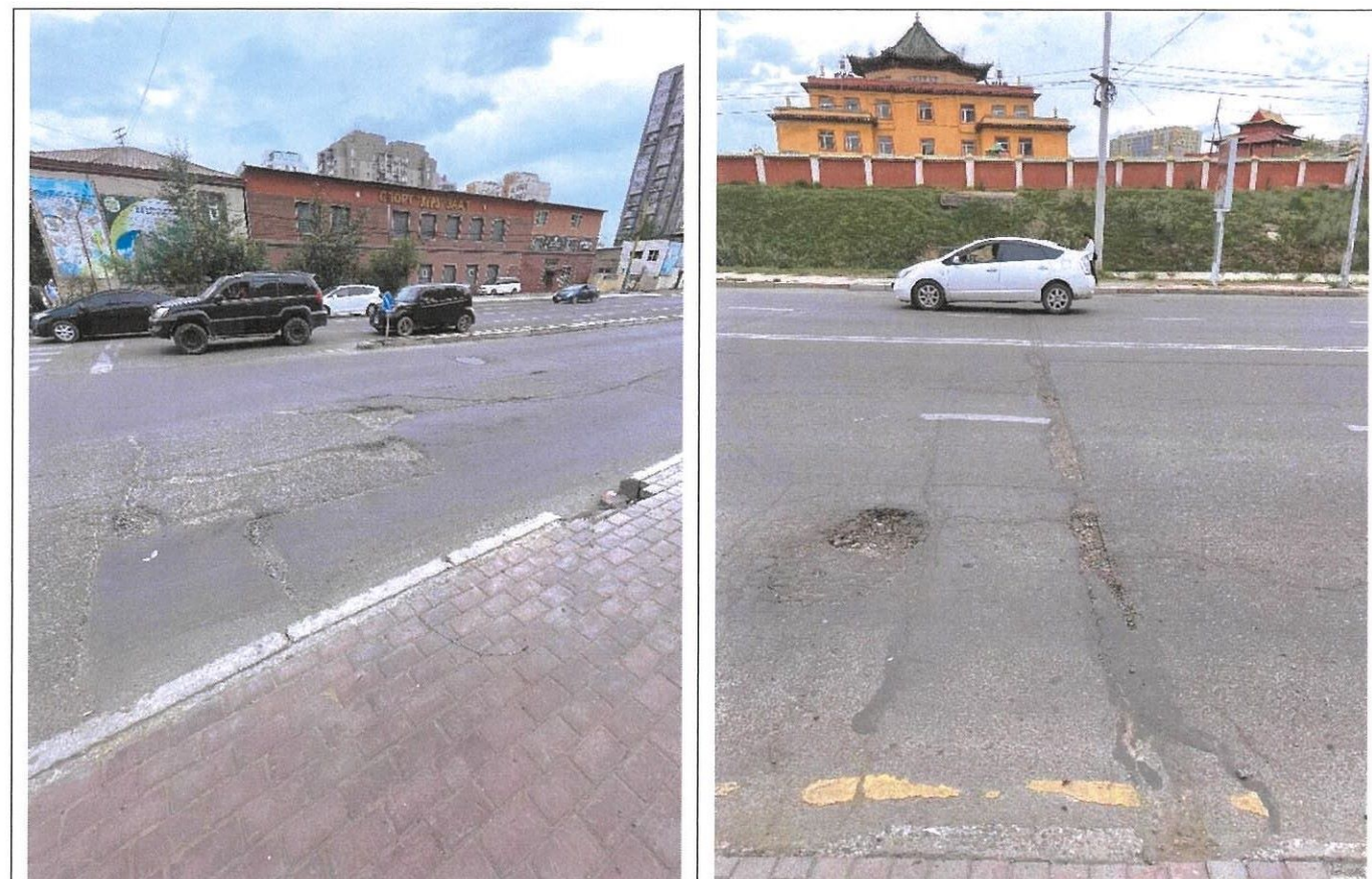
Замын дагууд нүхтэй хагарал ихтэй тул хөрөөдөн авч суурийн хамт зайлуулан нөхөөс хийнэ.
