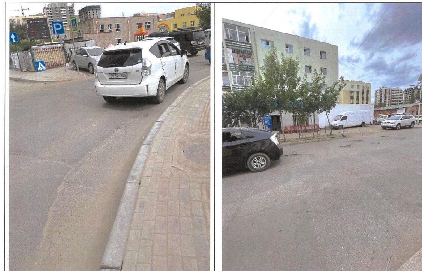
Замын урд хэсэг баруунаас зүүн чиглэлд авто замын урд хэсэгт дагуу хагарал ихтэй.
