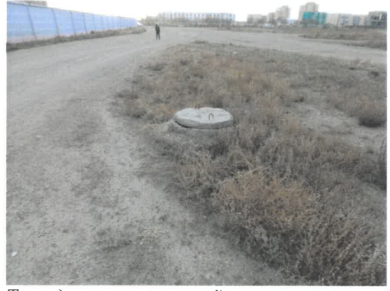
Трассд орсон инженерийн шугам сүлжээ энэ хэсэгт зиг заг хавтангаар хучилт хийнэ /0+026~0+420 хүртэл/
