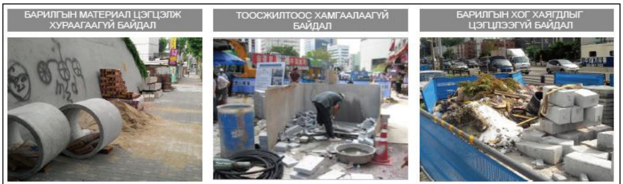
60-р зураг - Барилгын талбайн орчны нөхцөл хангаагүй байдал (ЖИШЭЭ)
