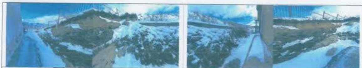
Фото зураг №5-8. 205-р цэцэрлэгийн барилгыг барих үед барилгын суурийг тэгшилж барьж байсан ба газрын гадаргын өндөржилтөөс хамааран нам дор хэсэгт 2.5м, өндөрлөг хэсэгт 5м гүнтэй үхсэн байна.
