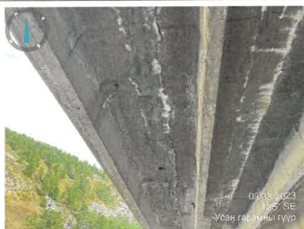
4.1 Ус зайлуулах цорго байхгүй
